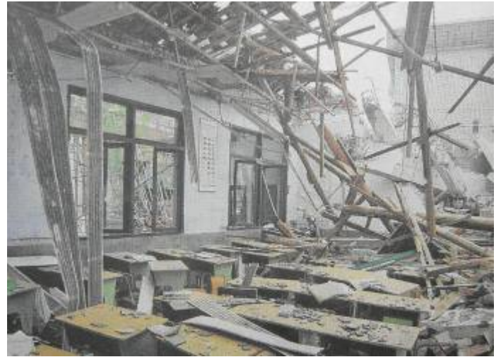
屋根が崩れ落ちた学校
